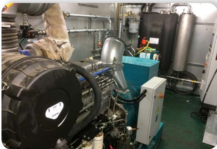
► Le moteur de cogénération
