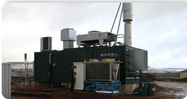
► Le moteur de cogénération
