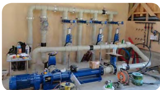
Les départs du réseau de chaleur
