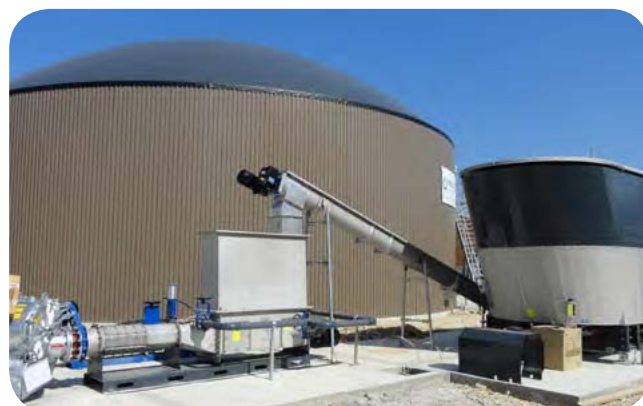
L'incorporateur (à droite) et le broyeur devant le digesteur
