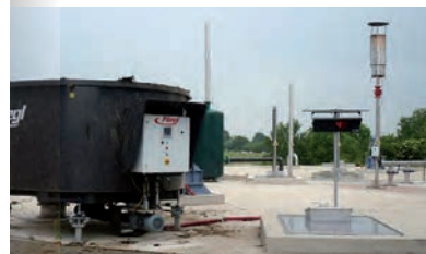
Alimentation du digesteur
