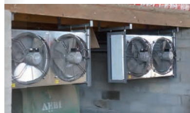
Ventilateurs et aérothermes pour le séchage
