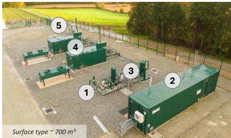
Vue d'une installation de rebours
